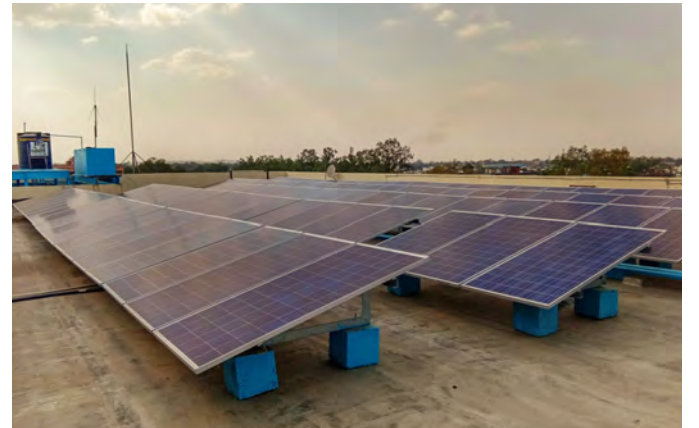
बीएचईएल भोपाल में घरेलू प्रयासों से विकसित 295 kWp सोलर रूफटॉप एसपीवी पैनल
